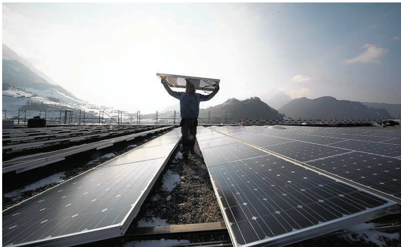
Strom vom Dach: Eine der flächenmässig grössten Solarstromanlagen der Schweiz steht auf dem Flachdach des Migros-Zentrums Länderpark im Nidwaldner Hauptort Stans.
